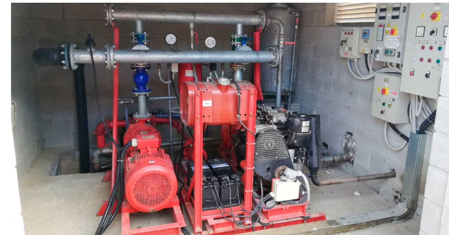
Sala pompe con gruppo Antincendio a norma UNI 9490 - Anno 1992 Pump room with Fire fighting unit UNI 9490 standard - Year 1992
