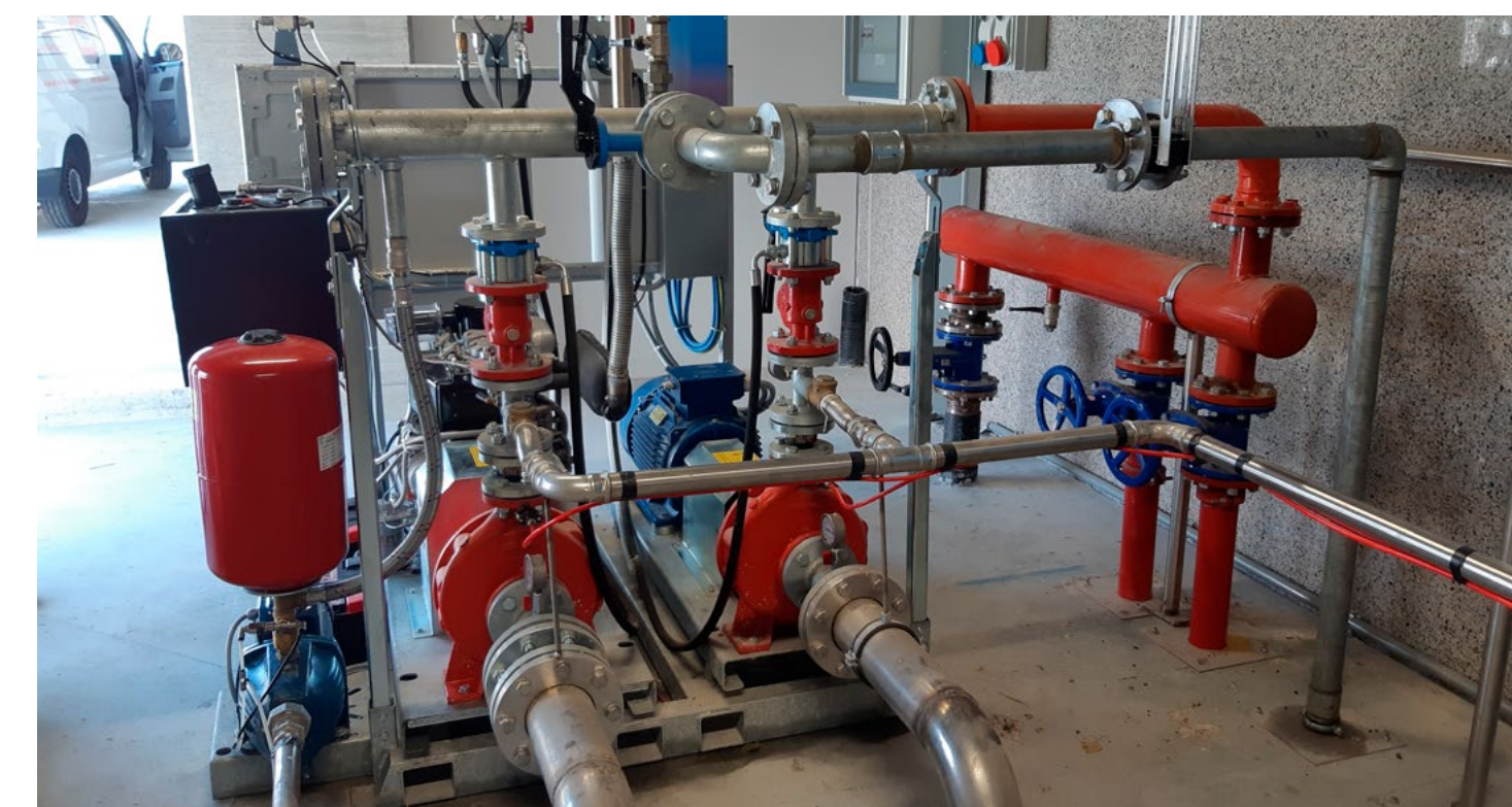
Sala pompe con gruppo Antincendio a norma EN12845:2015 - Anno 2019 Pump room with Fire fighting unit EN12845:2015 standard - Year 2019
